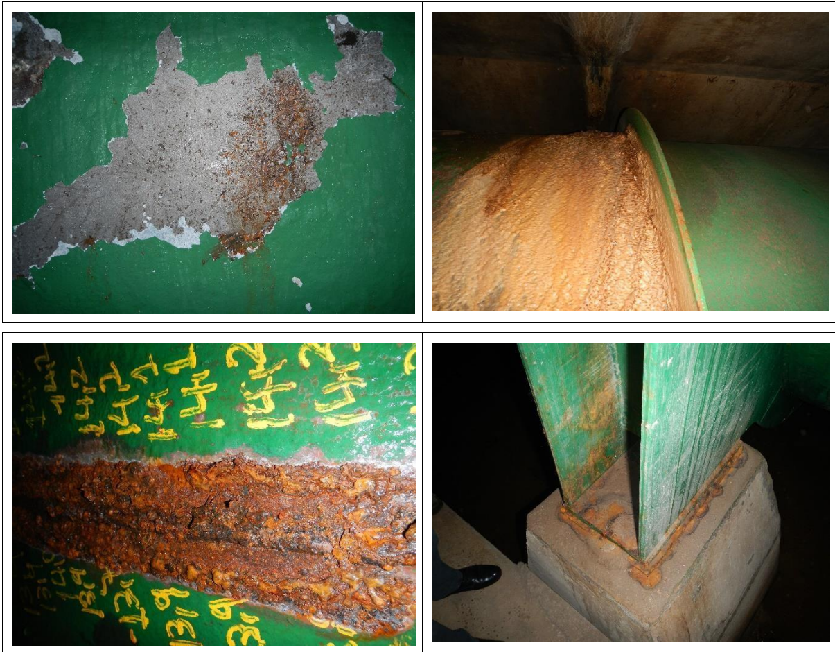
Fotografía 6.13 Estado del revestimiento anticorrosivo
