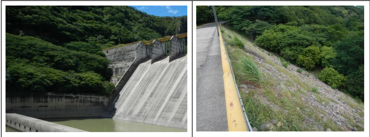
Fotografía 6.1 Estribos cubiertos de vegetación
