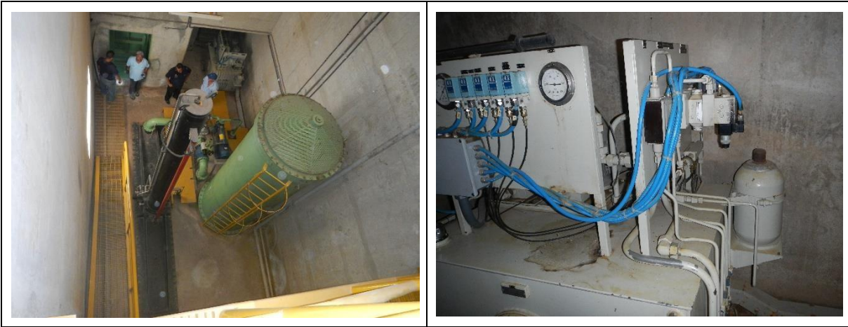
Fotografía 6.11 Cámara de operación y equipo oleo-electro-mecánico de accionamiento
