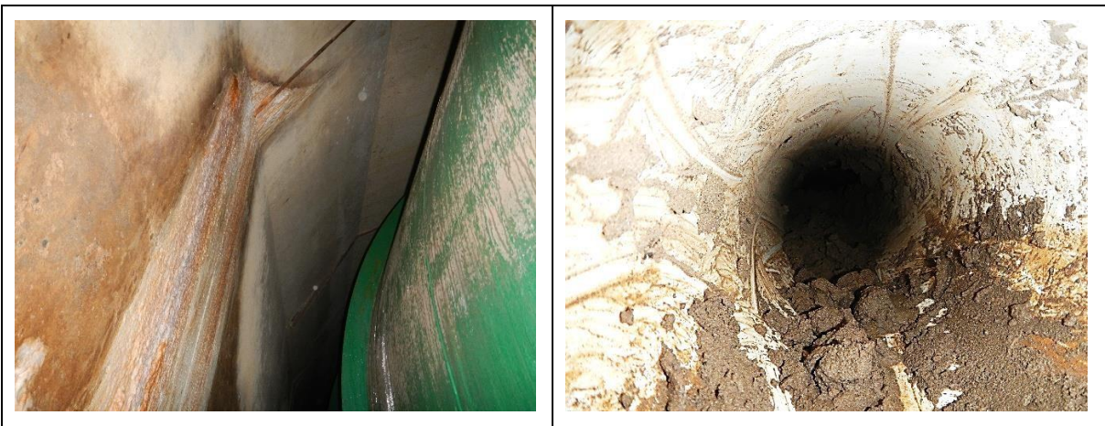
Fotografía 6.12 Fisura y depósitos de finos en dren
